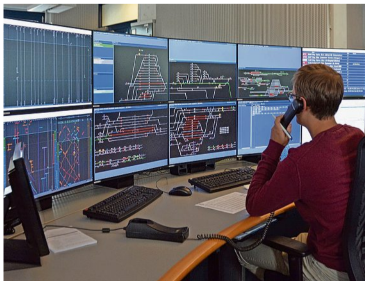
So präsentiert sich dem Zugverkehrsleiter der Bahnhof Brig an seinem Arbeitsplatz in der Betriebszentrale Spiez.
