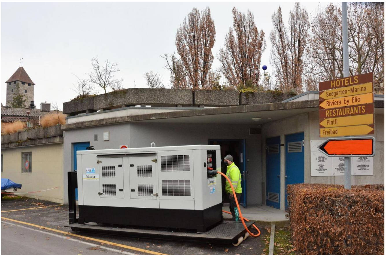
Getestet in der Spiezer Bucht: Mit der mobilen Notstromanlage lässt sich ein Totalausfall der Abwasser-Pumpstationen vermeiden. Foto: Guido Lauper
